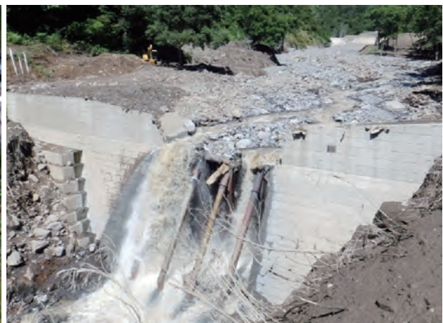
写真-7 砂防堰堤(格子型) 捕捉後
