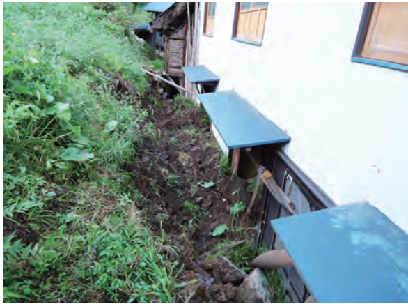
写真-3 長野市 上深沢地区
