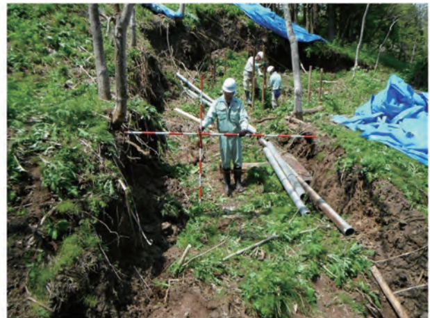
地すべり頭部の陥没帯
