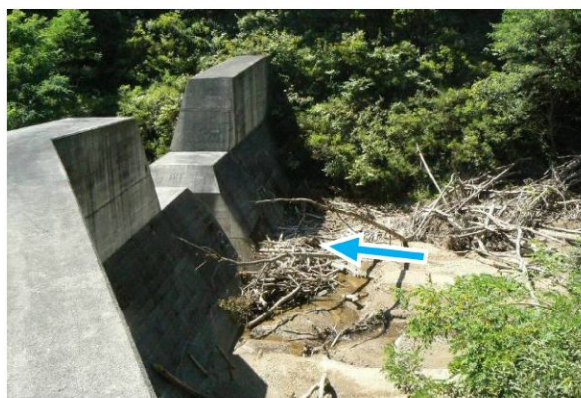
図-9 土砂及び流木捕捉状況 (掛札川)
