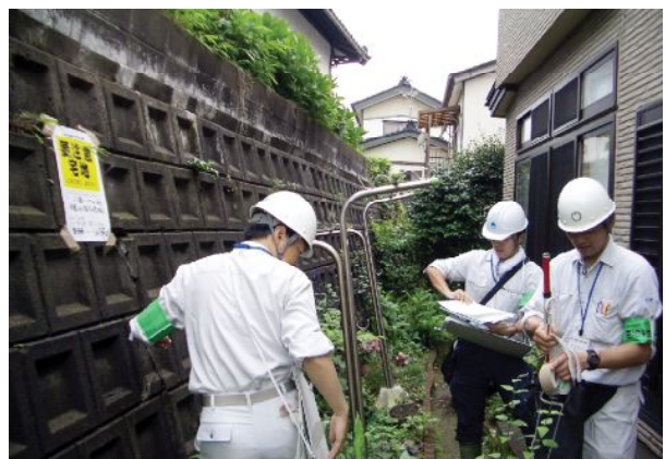
中越沖地震発生直後の宅地危険度判定
