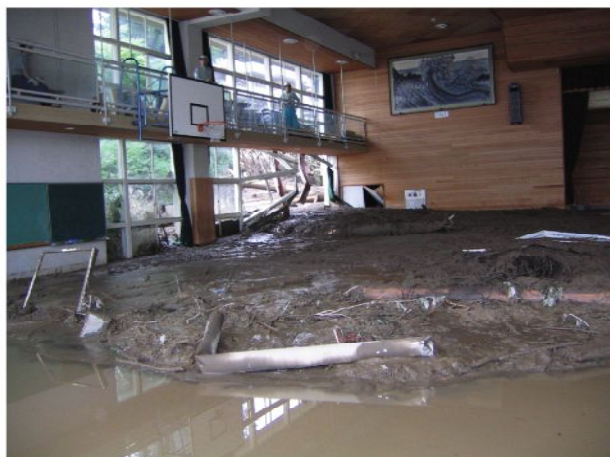
上の原小学校体育館に流入した土砂
