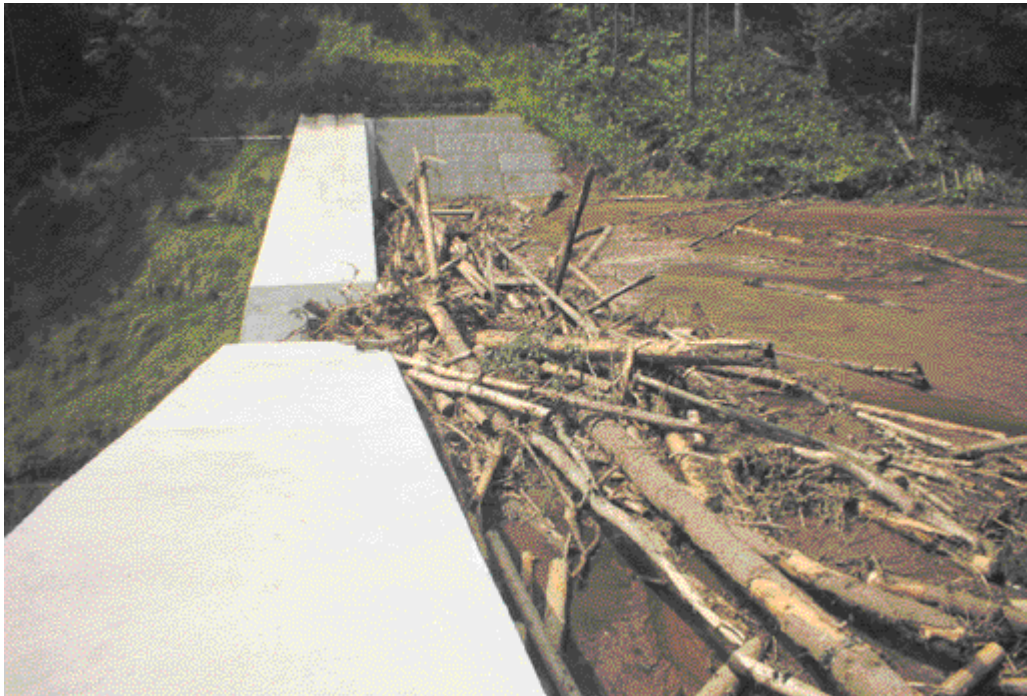
平成18年7月豪雨において土石流を捕捉し下流への被害を防いだ砂防えん堤 ~ 岡谷市間下 ヒライシ沢 ~
