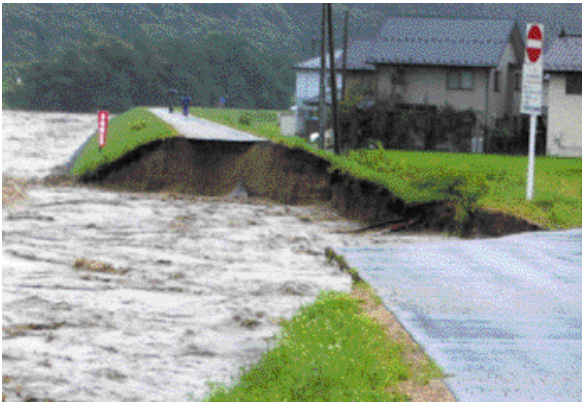
天竜川堤防決壊現場
