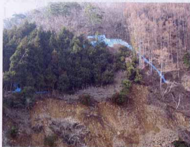
被災ブロック上部全景
