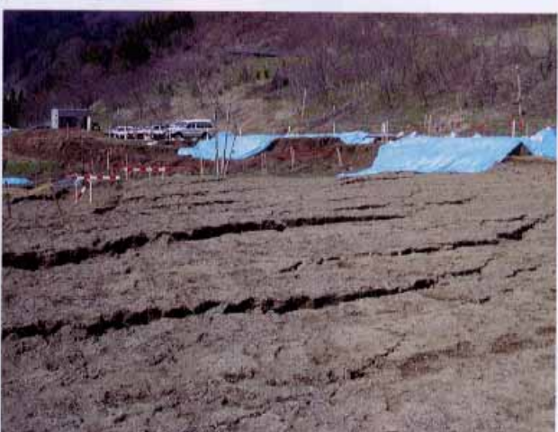
被災ブロック内の亀裂
