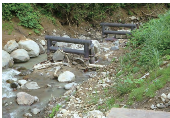
鋼製牛柵工流木捕捉状況
