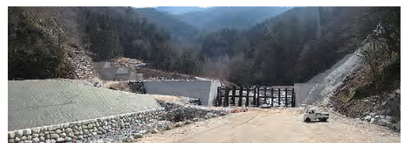
越百第3砂防堰堤工事 完成すると日本最大級の鋼製スリット 高さ21.0mの鋼製砂防堰堤 写真はH28.2末 鋼製スリット部高さは約7.6m
