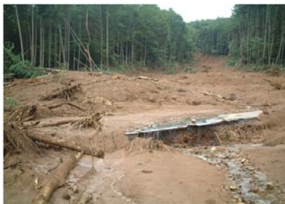
平成18年7月豪雨災害(岡谷市)
