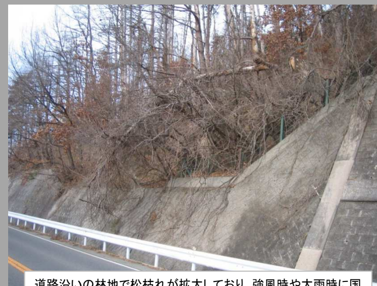
道路沿いの林地で松枯れが拡大しており、強風時や大雨時に国道への倒木が頻繁に発生する。
