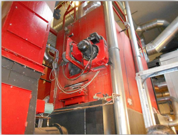
【チップボイラー】
