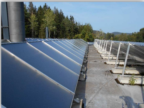
【屋上の太陽光パネル】
