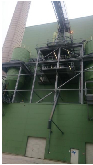
ボイラ棟とコンベア
