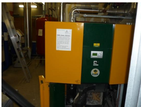
小型ボイラ (KWB 社製)
