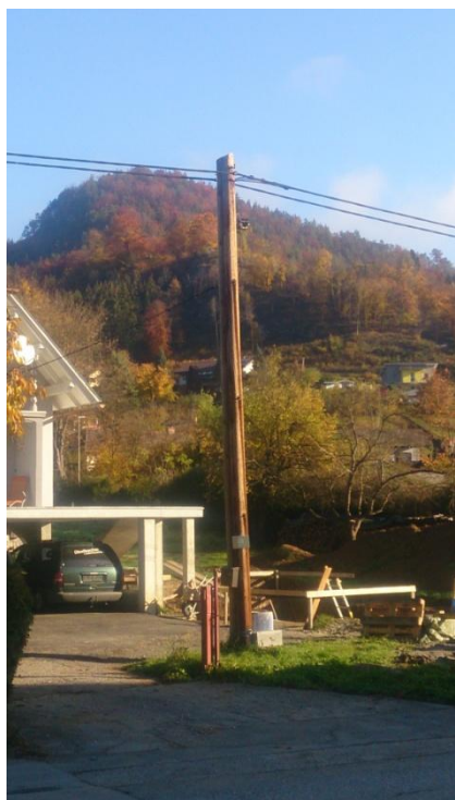
木製電柱（円柱でない例）
