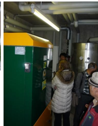
地下にKWB社の小型ボイラ
