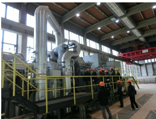
タービン・発電機
