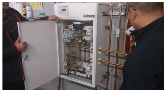
支線の熱交換ユニット (15kwh)
