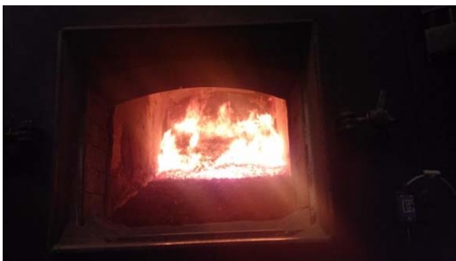
ボイラー燃焼状況
