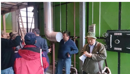
熱電併給施設 (ボイラー)
