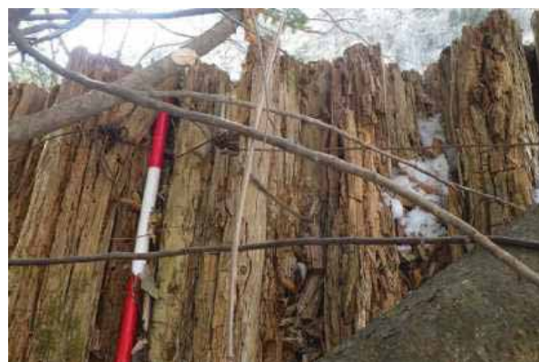
《対策実施前（損傷状況）》
