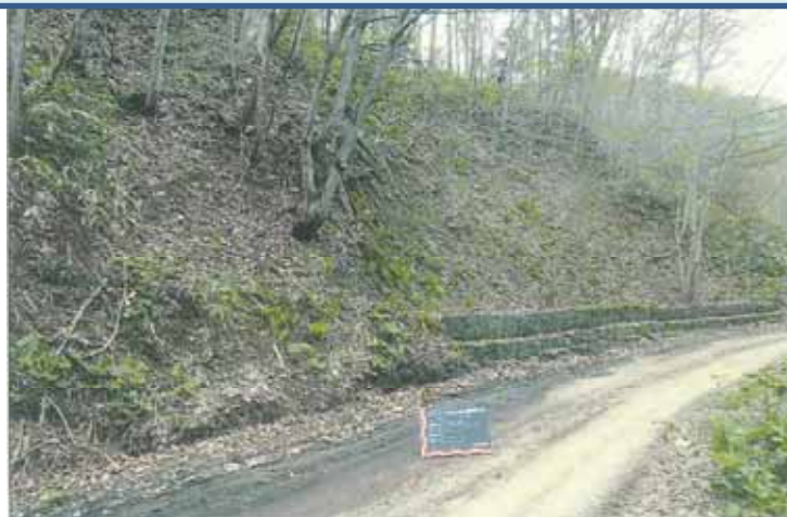
《対策実施前（損傷状況）》
