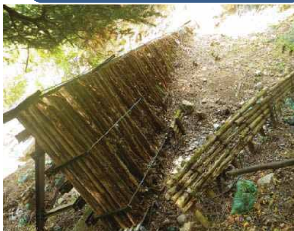
《対策実施前（損傷状況）》
