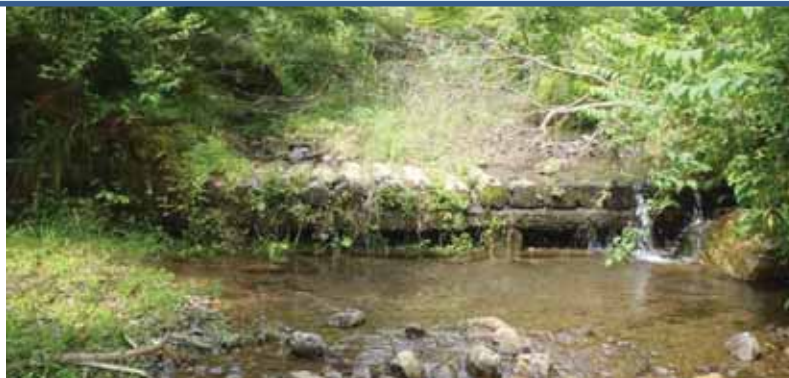
《対策実施前（損傷状況）》
