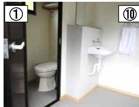
簡易水洗洋式トイレ内部(左)と、鏡付きの洗面台(右)
