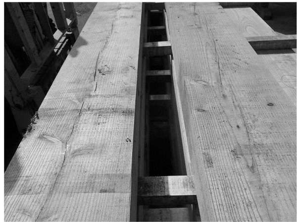
写真 2-4 木裏側の髓割れ
