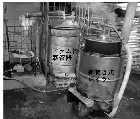
写真-1 薪焚き式ボイラーによる精油採取装置
