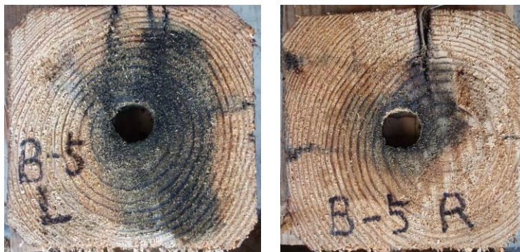
写真-3 材面割れから生じた2号型部材の内部劣化
