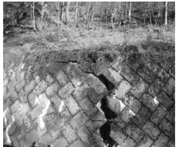
図-2 インターバルカメラにより撮影したブロック積の亀裂
