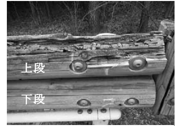
写真-1 腐朽状況
