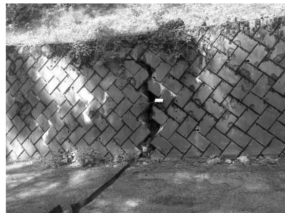
写真-1 道路のブロック積の亀裂
