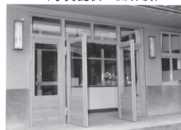
写真-7 事務所玄関建具
