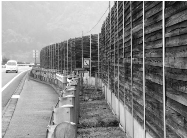
写真-2 設置後20年経過の状態（自動車道側）
