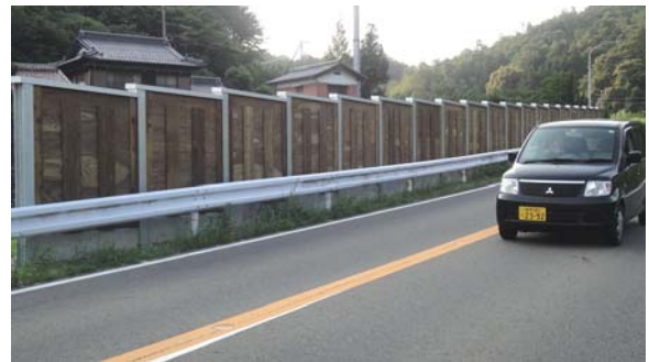
写真-3 国道に設置された防腐合板遮音壁
