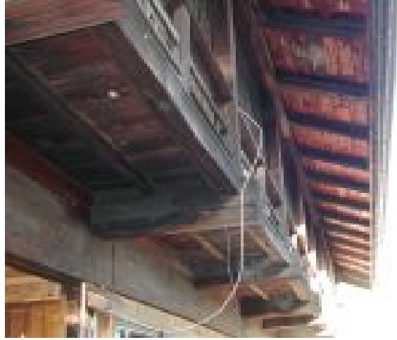
写真-3 同民家の2階張出し部分
