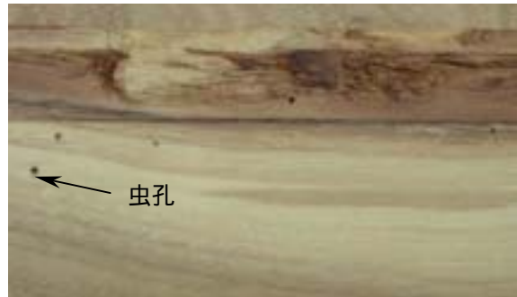
写真 - 1 被害材にみられる虫孔
