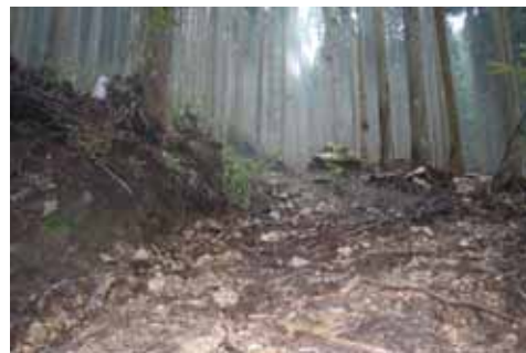
写真.2 路面侵食で使用できない
