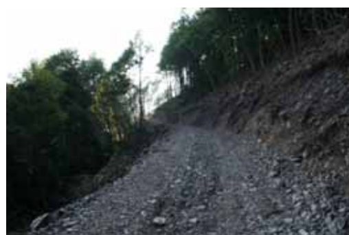
写真 5-14 堆積土石が連続する斜面 林道 3 級相当の森林作業道で、凹地崖錐地を通過。落石が頻繁に発生している。
