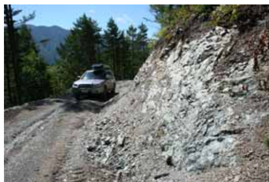
写真 5-20 作業道法面に露出した蛇紋岩
