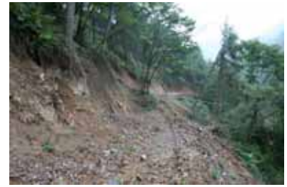
古期堆積岩地域における森林作業道の荒廃状況
