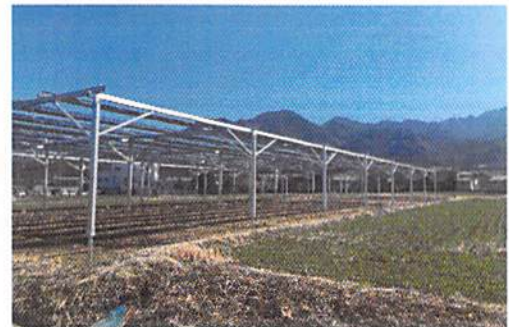
【発電所完成写真】
