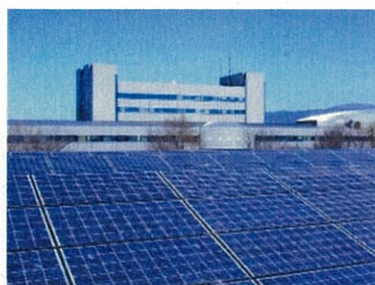
太陽光パネル
