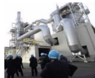
木質バイオマス発電所
