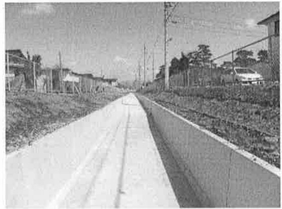
【更新後：更新により漏水等が解消】
