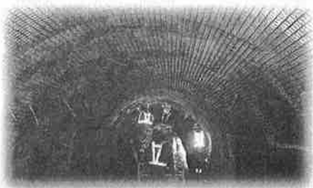
【県営かんがい排水事業】 改修工事中の水路トンネル 西天竜地区
