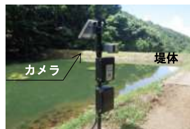
【ため池監視システムの設置】 （佐久市：常和上池）
