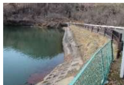
【耐震性能が不足していた堤体】
