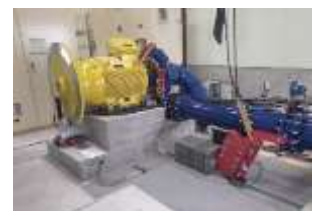
【野沢温泉村豊郷地区 小水力発電施設】
