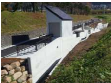
【沈砂池と上部水槽】
