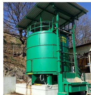
【堆肥化処理施設】
