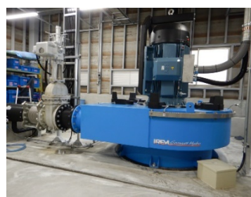
【内部の発電施設（発電水車部）】
