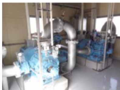
【更新した排水ポンプ】
