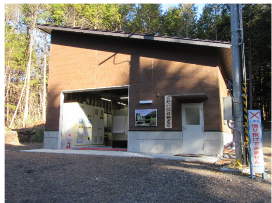
【農業用水を利用した発電施設（上松町）】
