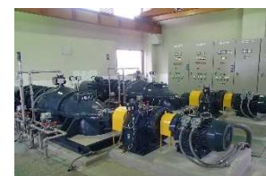
【整備した排水ポンプ設備】
