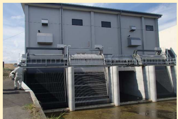
【整備が完了した排水機場：相之島排水機場（須坂市）】
