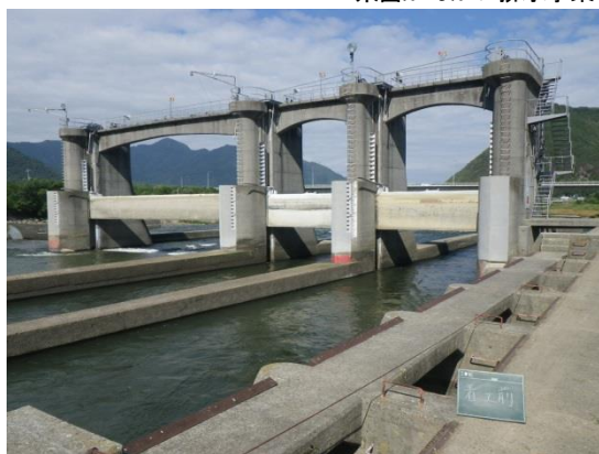
【築造後 50 年経過しコンクリートが劣化】
