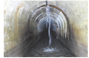
【補修が必要な水路トンネル】
