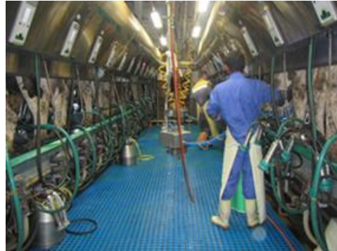
【ミルクングパーラー(搾乳設備)の整備】
