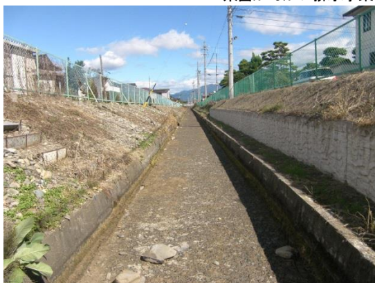
【更新前：農業用水の安定供給に支障】
