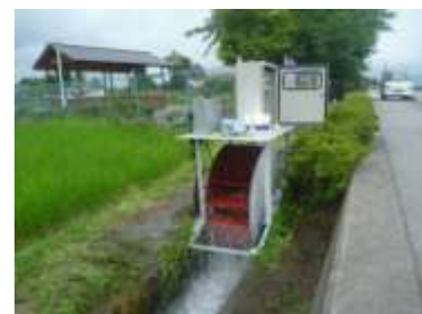
【農業水利施設を利用した小水力発電】
