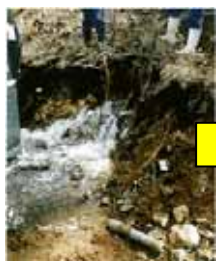
老朽化による管水路の破管・漏水事故が多発
