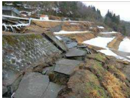
【農道の損壊（栄村横倉地区）】
