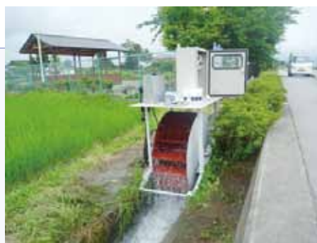
【農業水利施設を活用した小水力発電】
