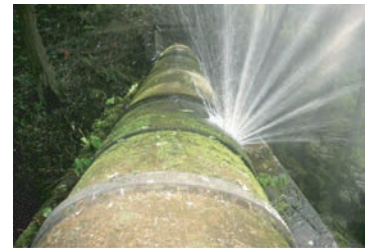
【老朽化が進行し漏水が著しい農業用水路】
