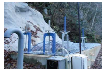
【沈砂池及びヘッドタンク】
