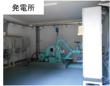
【農業用水を活用した小水力発電（南木曾町）】
