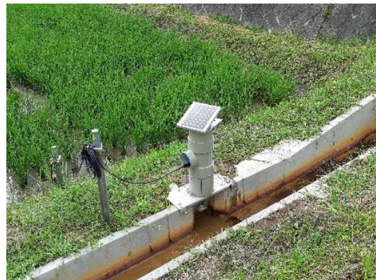
【遠方操作が可能な給水栓（二重地区）】
