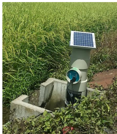
【ICTを活用した自動給水栓】
