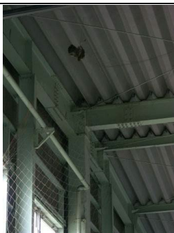
【○】防鳥ネットの設置
